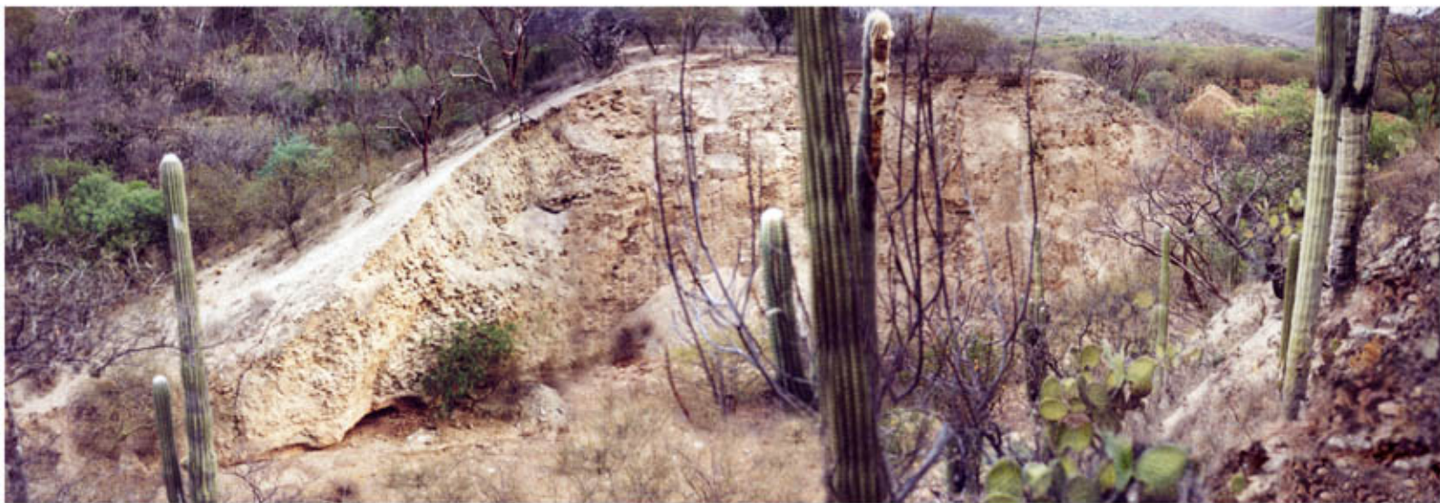
Vista del corte transversal de la Cara Sur de la cortina. En la esquina inferior izquierda a la izquierda del arbusto - se aprecia una socavación de aproximadamente un metro de altura, en lo que fue el primer nivel de construcción original de la presa, que permitió nivelar el fondo de la barranca para lograr un estancamiento del agua de escurrimiento.
